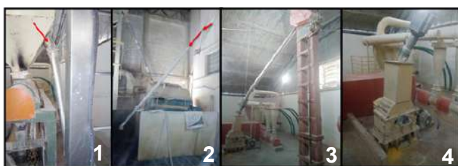
Figura 7- Cano de transborno; cano de transborno na moega; detector de metal; triturador
